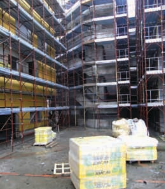
Immobilie residenziale pubblica di via Fornarina: una fase della cappottatura esterna del corpo A.
